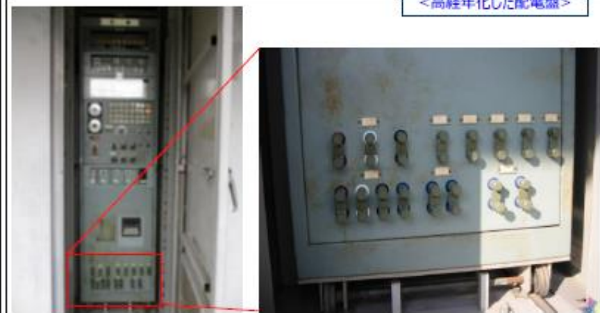
<高経年化した配電盤>
