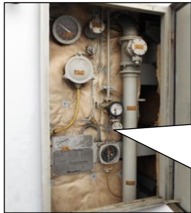
配電塔変圧器
