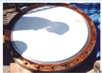
機器接合部に錆が発生
