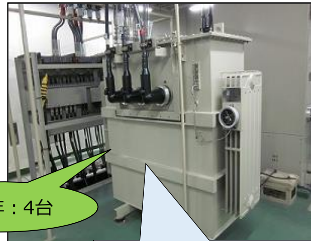
特高変圧器 (22kV/420V)
