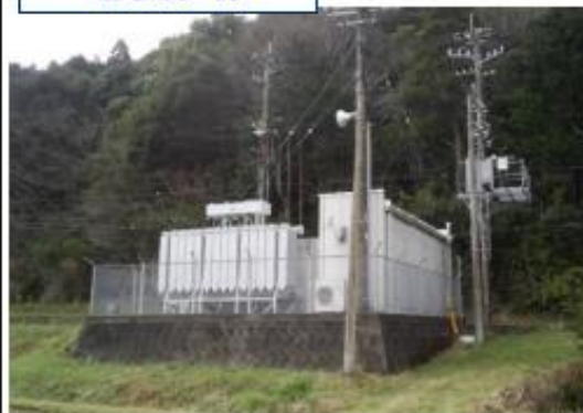
<配電塔の一例>
