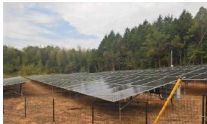
＜小規模太陽光発電設備＞
