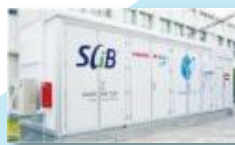
関西電力 エネルギー利用技術研 究所内 100kW-300kWh
