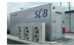
横浜スマートシティ プロジェクト 300kW-100kWh
