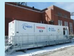
Duke Energy (USA) 2MW-0.8MWh
