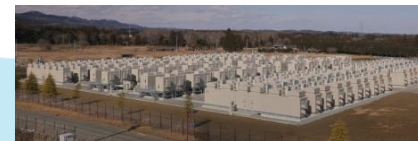
東北電力 南相馬変電所 40MW-40MWh
