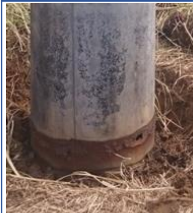
地際部の腐食事例
