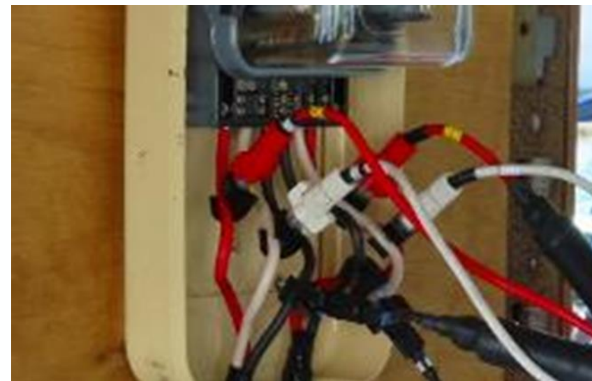
<計器際配線にバイパス装置を取付した例>
